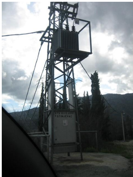
Slika 6.48. TS STINJEVAC 10/0,4kV
