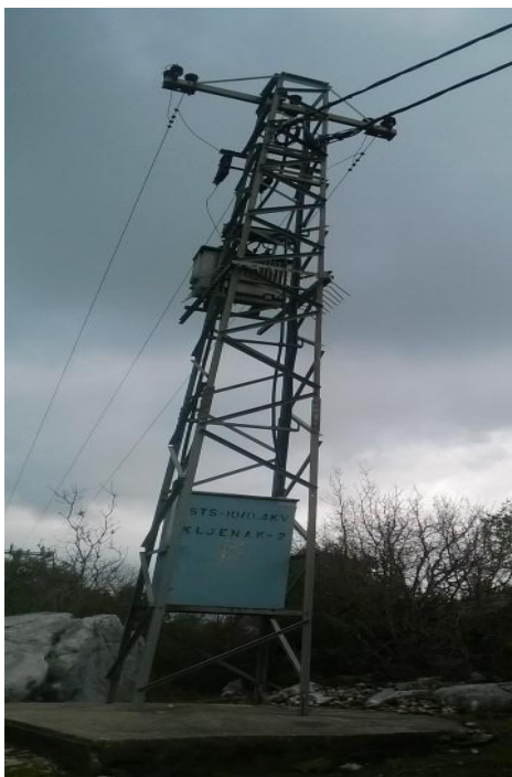
Slika 6.62. STS KLJENAK 2 10/0,4kV
