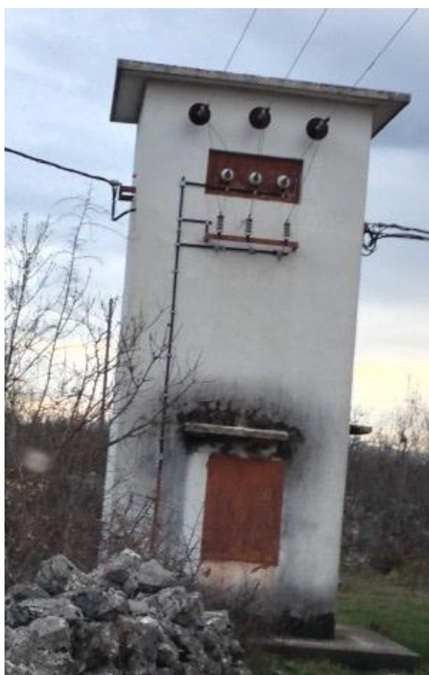
Slika 6.1. TS DRAGLJANE 10/0.4 kV
