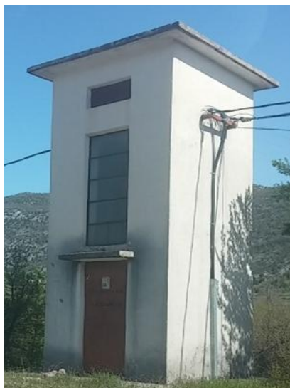
Slika 6.53. STS RAŠĆANE 3 10/0,4kV
