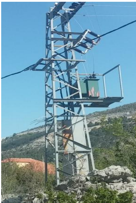
Slika 6.52. TS RAŠĆANE 2 10/0,4kV
