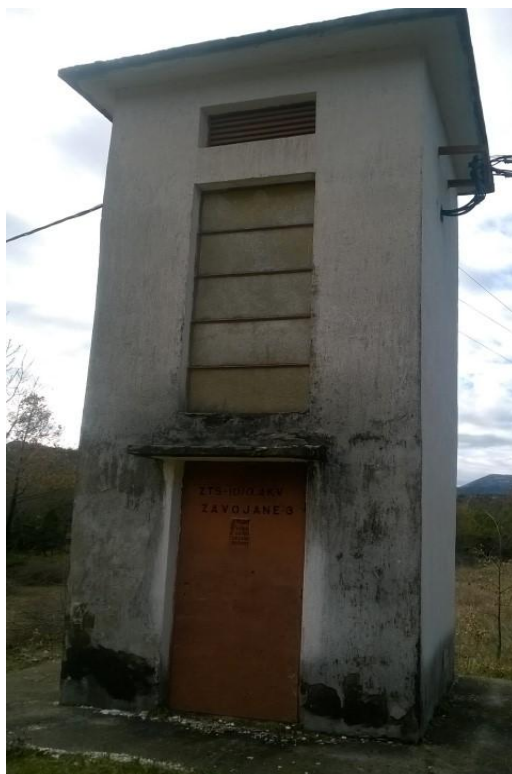
Slika 6.3. ZTS ZAVOJANE 3 10/0,4 kV
