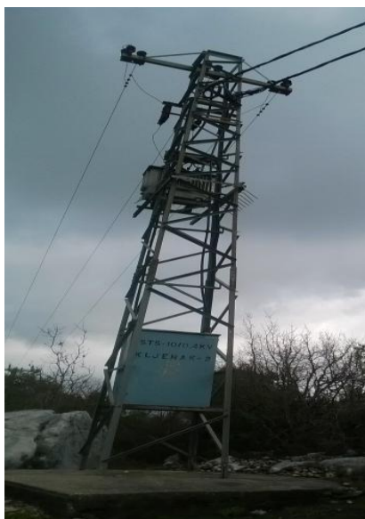
Slika 6.61. STS KLJENAK 1 10/0,4kV
