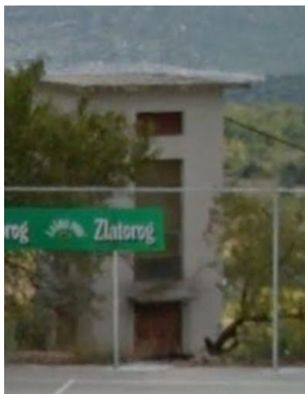
Slika 6.7. TS ZAVOJANE 2 PIVCI 10/0,4kV
