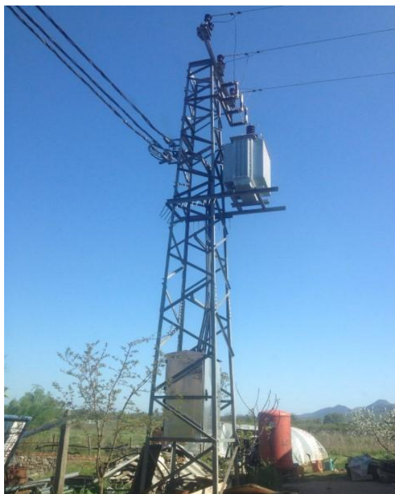
Slika 5.7. Tipika trafostanica 10/0,4 kV
