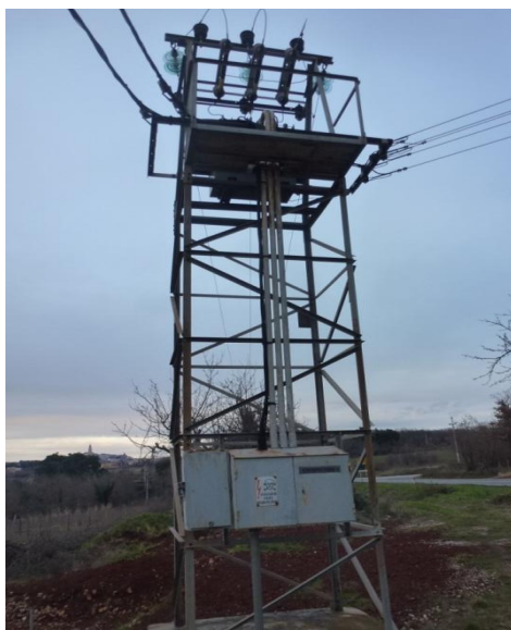
Slika 6.32. STS KOKORIĆI 2 ŠARE 10/0,4kV
