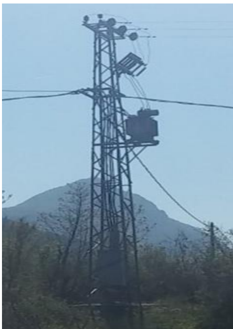
Slika 6.54. STS RAŠĆANE 4 10/0,4kV
