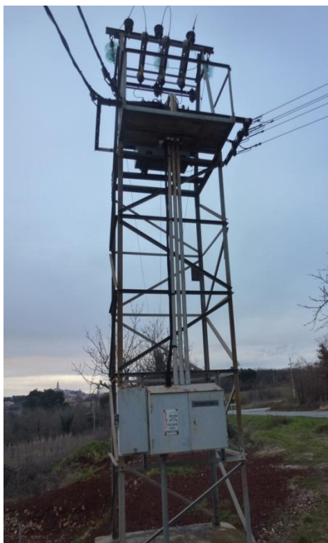
Slika 6.42. TS PRAPATNICE 3 10/0,4kV
