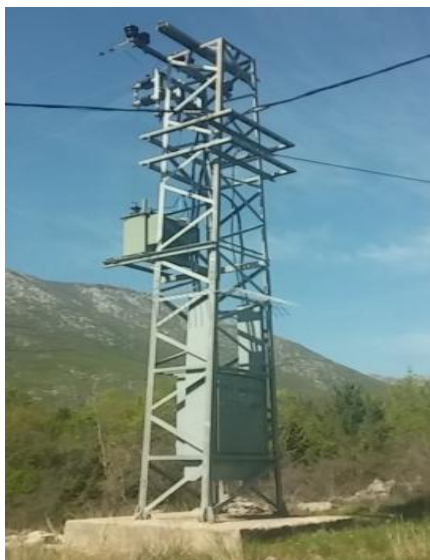
Slika 6.55. STS RAŠĆANE 5 10/0,4kV
