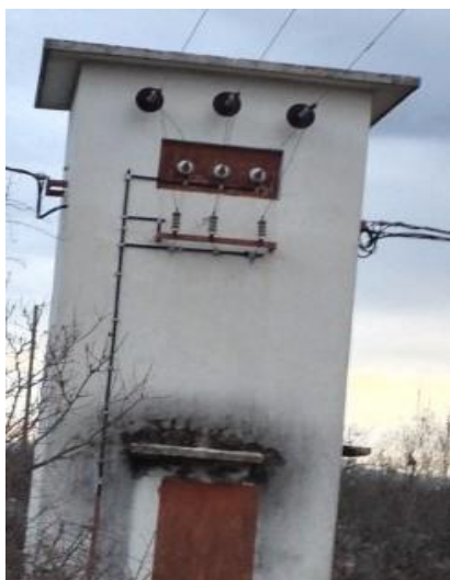
Slika 6.30. TS BANJA CIKOJE 10/0,4kV
