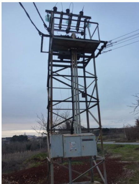
Slika 6.26. TS DRAŽEVITIĆI 2 10/0,4kV
