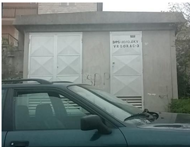
Slika 6.10. TS VRGORAC III 10/0,4 kV
