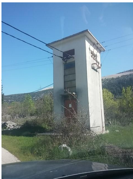
Slika 6.51. TS RAŠĆANI 1 10/0,4kV
