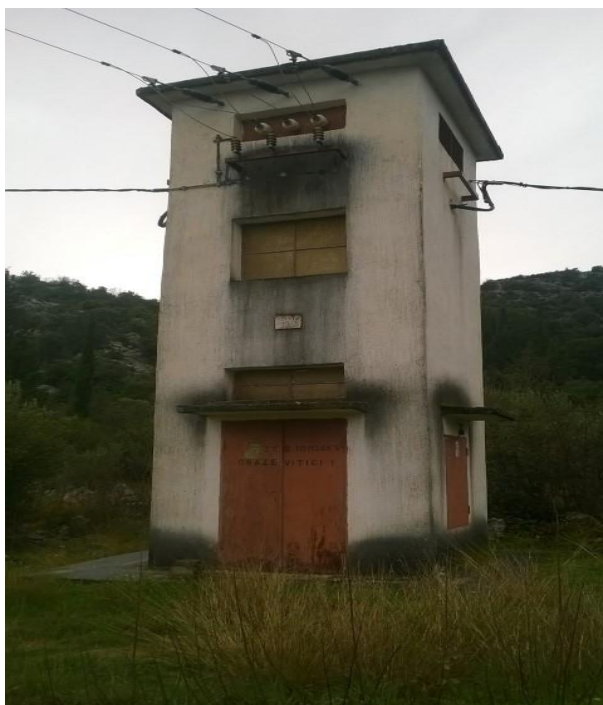
Slika 6.25. TS DRAŽEVITIĆI 1 10/0,4kV
