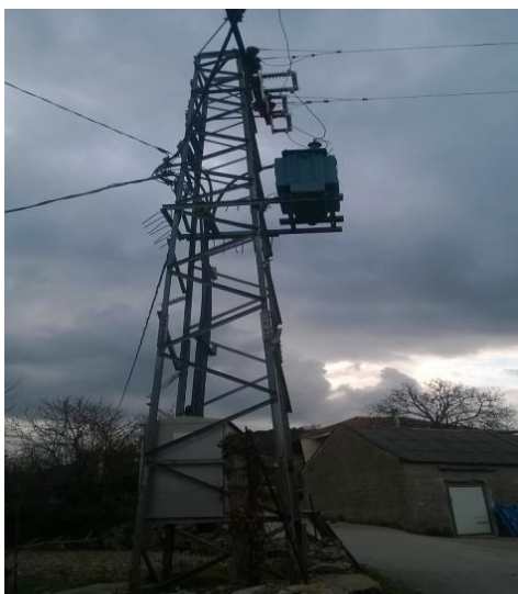
Slika 6.15. TS VLAKA 10/0,4 kV
