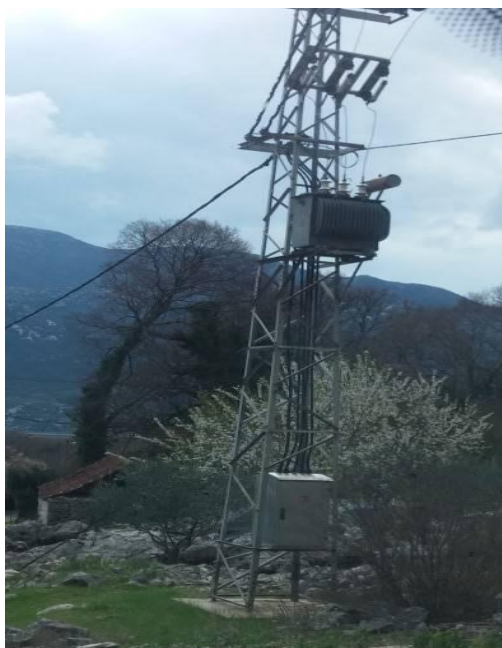
Slika 6.36. STS KOTEZI 2 10/0,4kV
